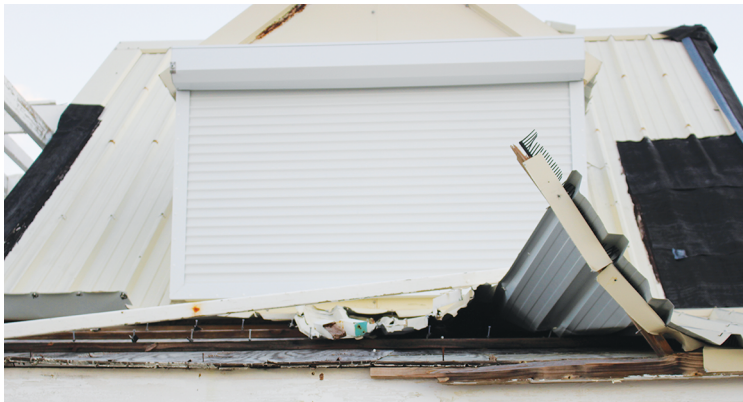
Figure 3 : Liteau de section trop faible et/ou trop peu fixé
