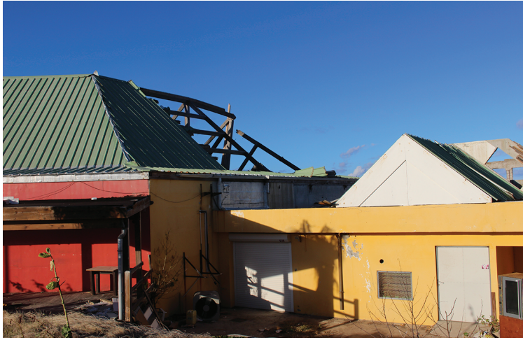
Figure 5 : Charpente mal contreventée
