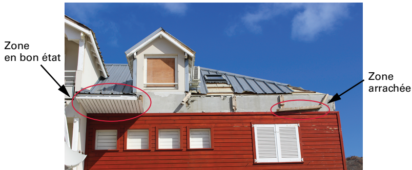
Figure 4 : Débord de toiture sous-dimensionné
