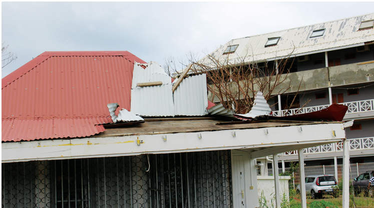
Figure 6 : Soulèvement en bord de toiture - tôle trop fine et pas assez raide, fixation ponctuelle entraînant une perforation
